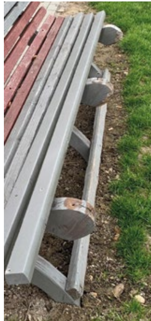
Abgerissene Latten an einer Bank - es besteht zudem Verletzungsgefahr durch herausragende Nägel
